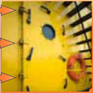
Gleitlager in Türbändern
